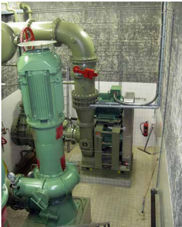
Rioolgemaal Groot Colmschate
